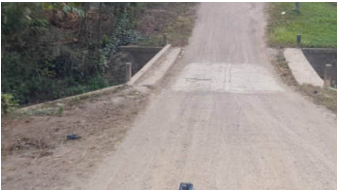
Foto 3. Puente estrecho en municipio de Quilalí. Indica riesgo de las personas e incluso de los vehículos que transitan sobre él. Es uno de los beneficios resultantes del proyecto, disminuir estos niveles de exposición a riesgos durante la movilización de las personas en la zona.
