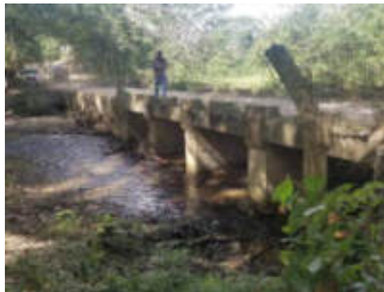
Ilustración 2 Obra de drenaje mayor Est. 0+690 acceso Centro de Salud N°2
