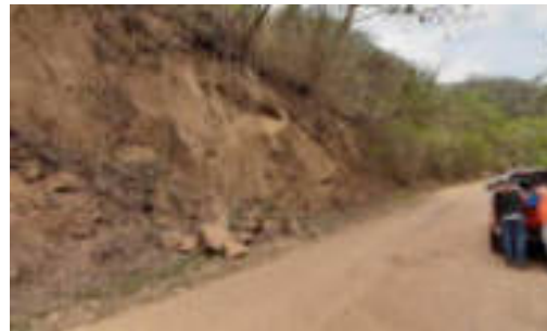
Caídos Sobre la Vía
