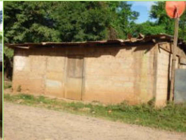
Propietario: Aneya Vianney Moreno Blandón Estación: 24+460 Banda: D Afectación: Total Cgo. SISCAT: 0707-U001-009-63
