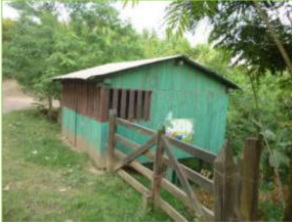
Figura 25. Propietario: Matilde Flores. Esta propiedad no está declarada. Estación: 14+000 Banda: D Afectación: Total
