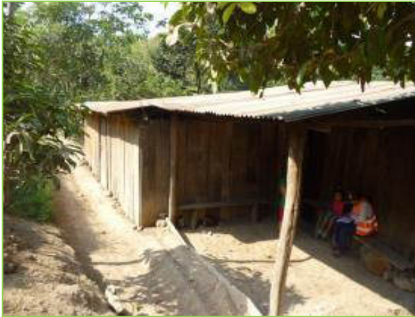
Figura 19. Propietario: Carmela Loasiga Miranda. Esta propiedad no está declarada. Estación: 8+050 Banda: D Afectación: Total
