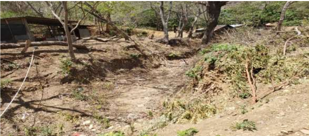
Fotografía 23. Est.21+760 canal longitudinal de 200 metros que representa una amenaza ante inundación para el proyecto.
