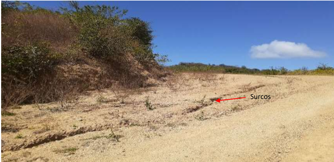
Fotografía 24. Surcos sobre el rodamiento existente en la Est.12+370 debido a la escorrentía superficial que están deteriorando actualmente la vía por falta de drenaje transversal y longitudinal.
