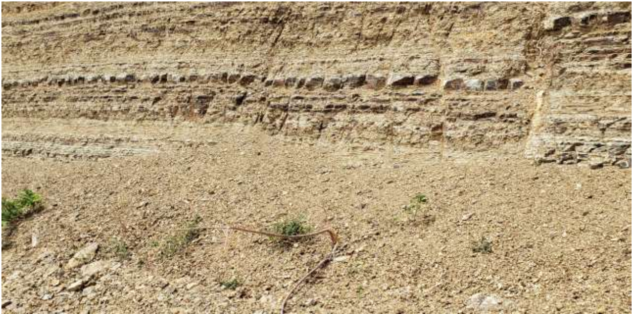
Fotografía 21. Talud en la banda derecha est.5+060.
