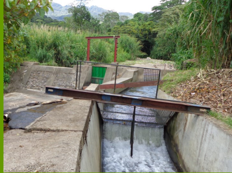
Proyecto reembolsable financiado por medio de BAC, Nicaragua con una generación de 2.7 MW. Hidroeléctrica Las Cañas, Nicaragua
