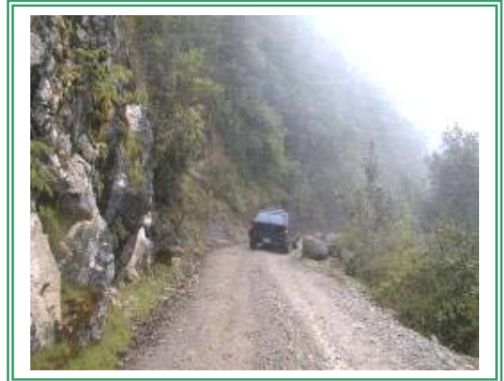
Fotografía 23. Punto observado 39, Caída de bloques en tramo estrecho del camino
