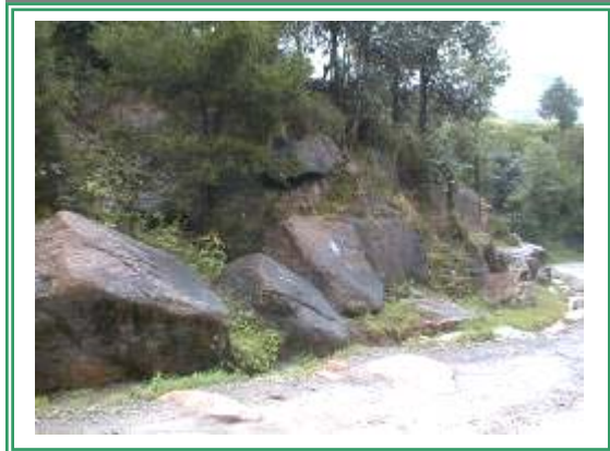
Fotografía 13. Punto observado 13, Zona de deslizamiento y caída de bloques de arenisca.
