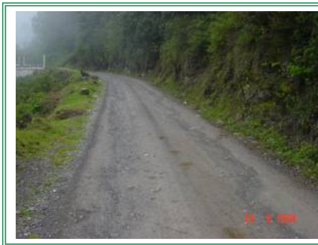
Fotografía 1. Carretera existente entre el municipio de San Miguel Acatán y la bifurcación con la RN-9 Norte, en el lugar conocido como Isnancob
