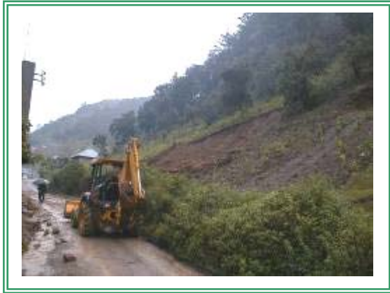
Fotografía 26 Punto observado 44. Deslizamiento de terreno situado en una zona de falla. Se observan evidencias de actividad y recurrencia problemática. Requiere de trabajos de estabilización. Punto crítico para mantener la vía expedita.
