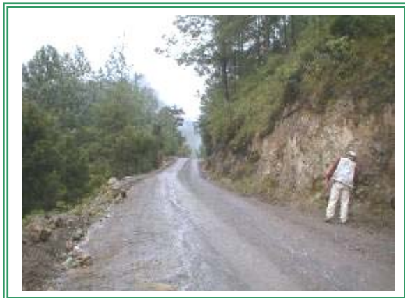
Fotografía 16. Punto observado 24, tramo de camino muy estrecho en caliza brechosa. Desprendimiento de bloques deaueños.
