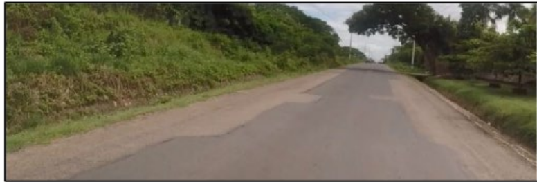
Ilustración 2. Vista de la superficie de rodadura con grandes áreas de bacheo
