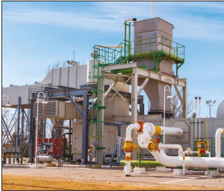
Imagen 20: Planta compresora tipo, similar a la futura Chacharramendi.
