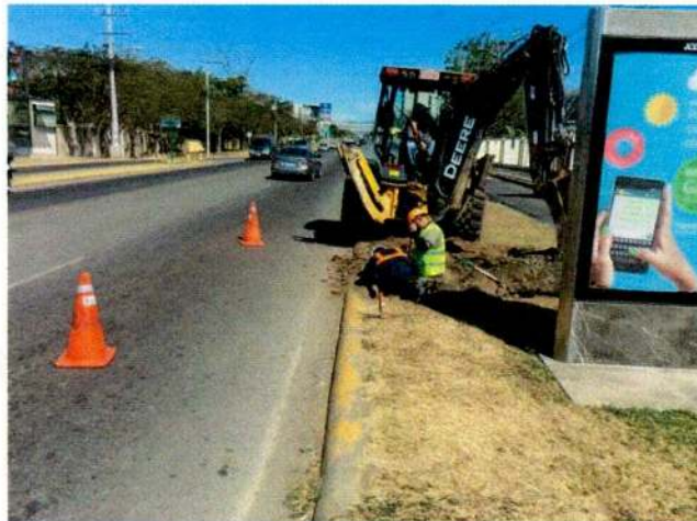
Foto 3: Condiciones del sitio durante los trabajos de auscultación del pavimento y retroexcavadora tipo back-hoe utilizada para las excavaciones y muestreo
