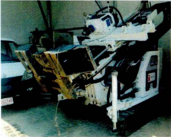
Foto 1: Equipo de perforación utilizado para la ejecución de las perforaciones a rotación.
