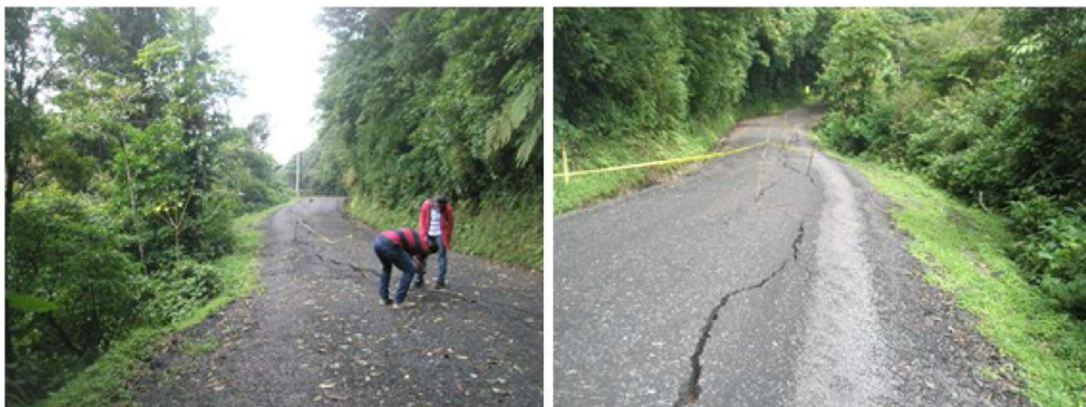
Fotografía 2.2. Vía 620. Fuente: Informe geológico de deslizamiento, 2020.
