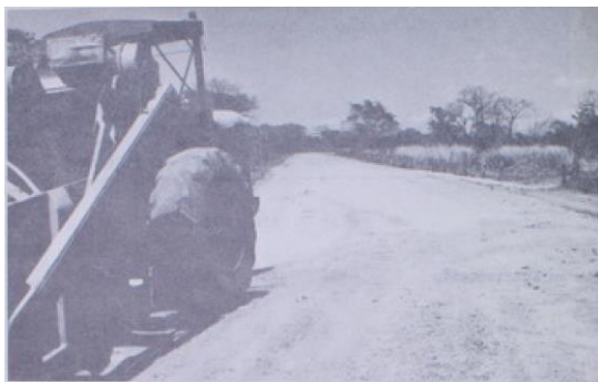
La Irma –Colorado, 1969 Fotografía N° 1
