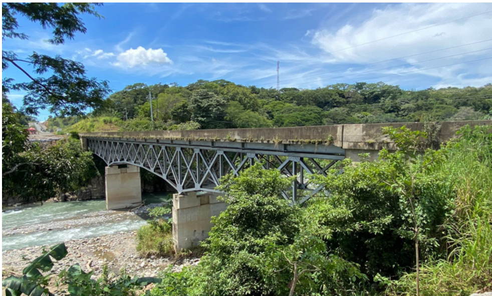
Figura 32. Estado del puente sobre el río Abangares (fotografía tomada por el equipo consultor el 7 de noviembre, 2022)
