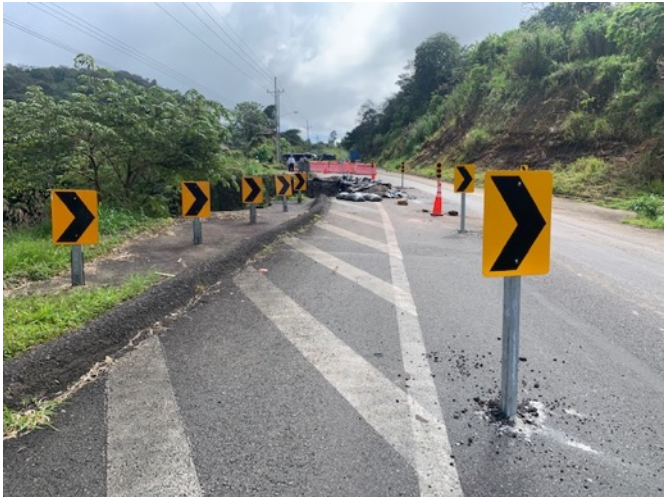
Figura 47. Afectación en carretera en el km 67 sobre la Ruta 1. (Fotografía tomada por el equipo consultor el 2 de noviembre del 2022)
