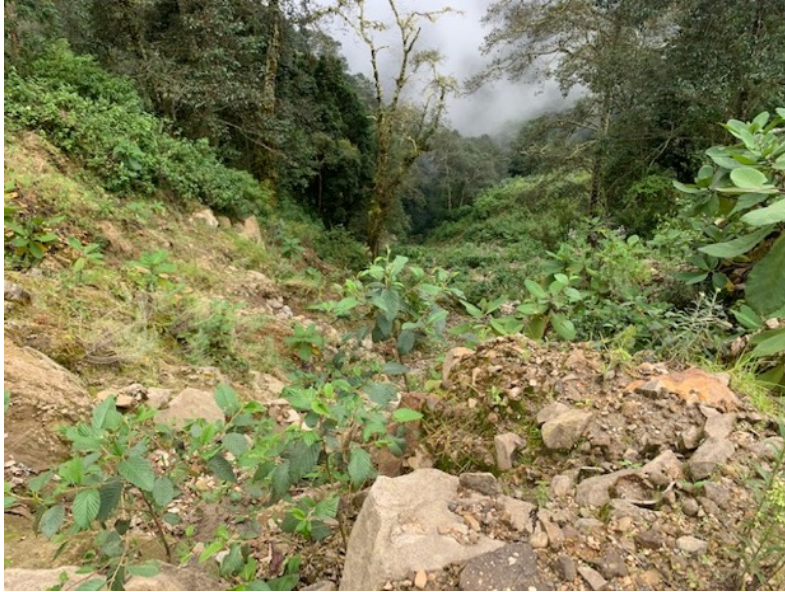
Figura 42. Deslizamiento en el km 102 sobre la Ruta 2. Afectación de la flora y el suelo en el margen inferior de la carretera (Fotografía tomada por el equipo consultor el 1 de noviembre del 2022)
