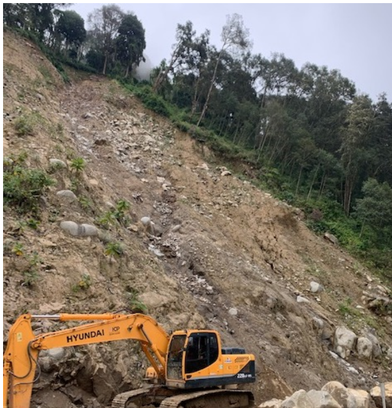
Figura 43. Obras de conservación vial CONAVI por el Deslizamiento en el km 102 sobre la Ruta 2. (Fotografía tomada por el equipo consultor el 1 de noviembre del 2022)
