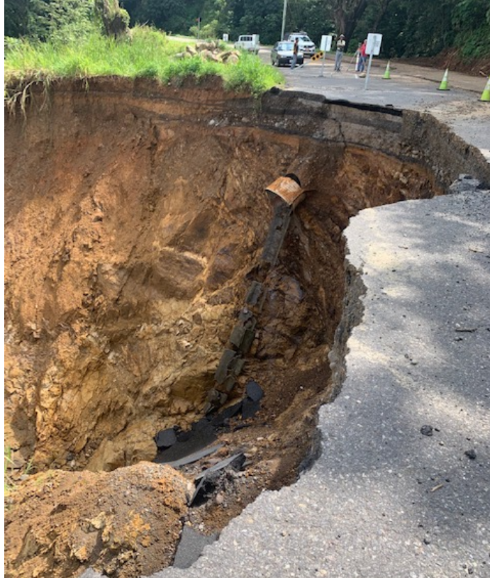
Figura 48. Afectación en carretera en el km 70 sobre la Ruta 1. (Fotografía tomada por el equipo consultor el 2 de noviembre del 2022)
