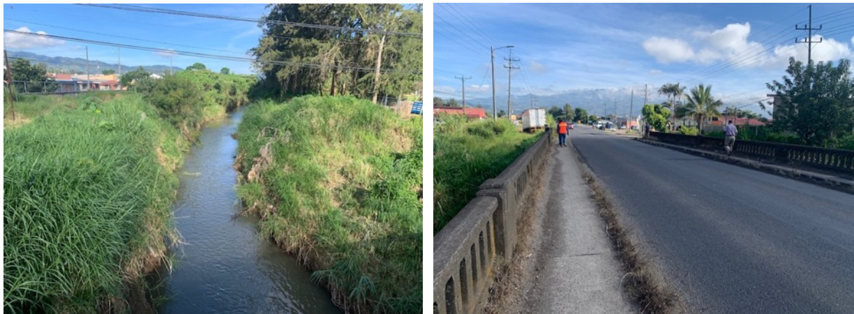
Figura 34. Estado del puente y cobertura vegetal en el área de protección del río Purires, Cartago (fotografía tomada por equipo consultor el martes 1 de noviembre, 2022)
