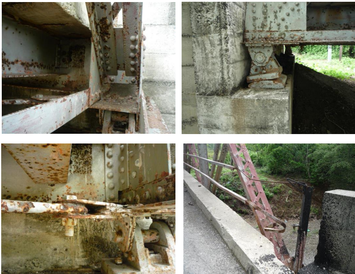
Figura 6. Estado de los elementos estructurales de acero
