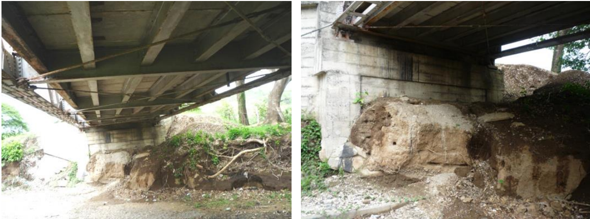
Figura 5. Socavación de los bastiones
