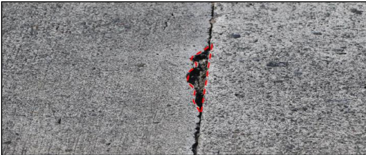
Figura 2. Desprendimiento de concreto en juntas de construcción, puente sobre el río Ciruelas.
