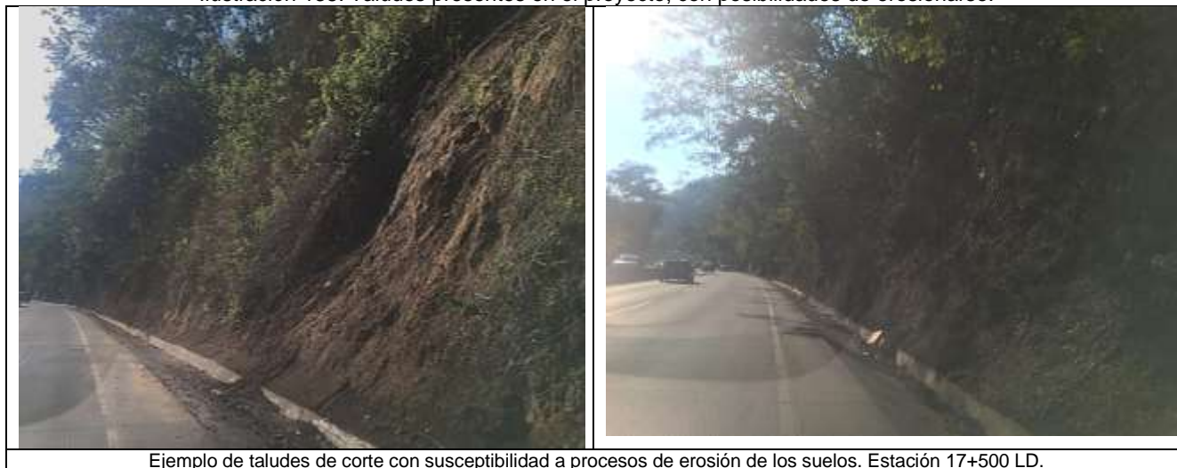
Ilustración 138. Taludes presentes en el proyecto, con posibilidades de erosionarse.
