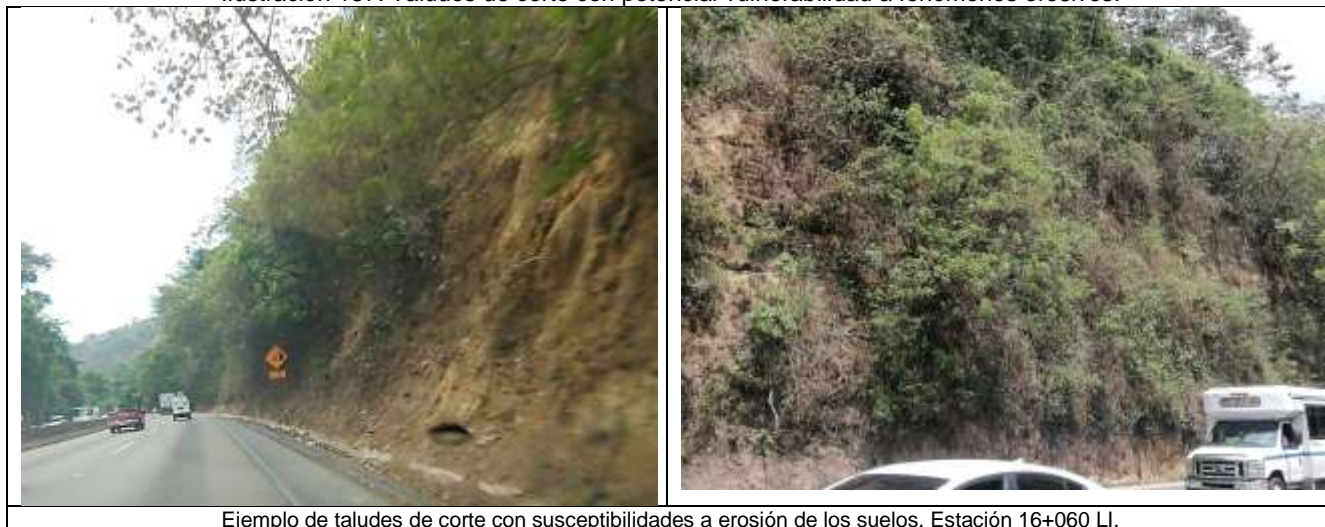
Ilustración 137. Taludes de corte con potencial vulnerabilidad a fenómenos erosivos.
