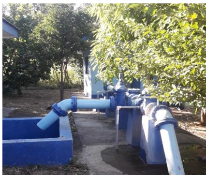
Foto 3. 1 Pozo Mateare, ubicado en el Barrio Dios Proveerá
