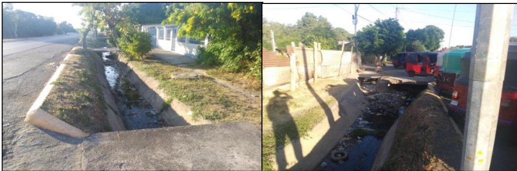
Foto 12: Cauce paralelo a la carretera utilizado para vertido de aguas residuales y residuos sólidos urbanos, en la ciudad de Nagarote
