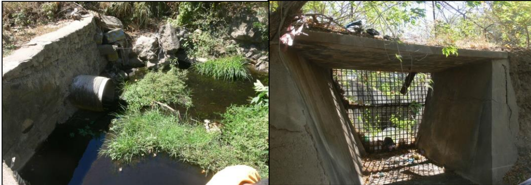
Foto 39: Izq. Punto de Descarga vertidos Planta Che Guevara Dcha. Cauce de aguas pluviales de la carretera
