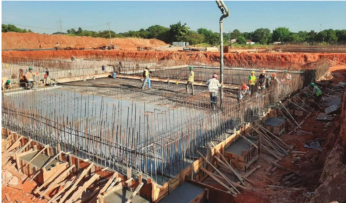
Imagen 21: Ejemplo de áreas de excavación despejadas de sitios de colocacion de material de coste, disminuyendo la erosión y movimiento de material a zonas de trabajo.
