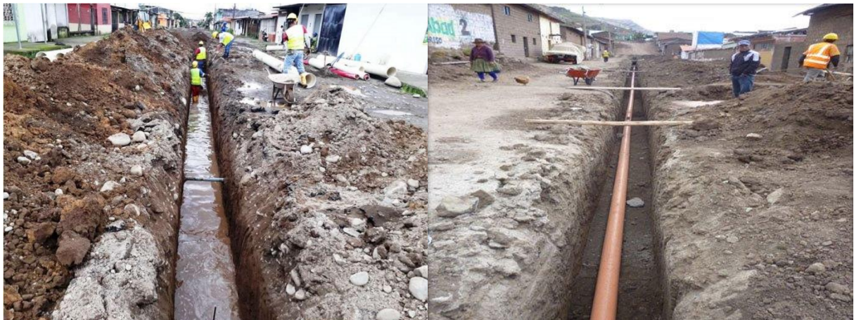
Imagen 22: A la izquierda, el ejemplo de una zanja con aguas pluviales y material colocado riesgosamente. A la derecha, una zanja despejada de material de coste, a una distancia segura.
