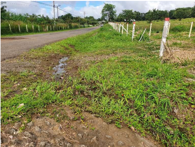
Fotografía 18: Canal triangular incompleto-Falta completar infraestructura hasta punto de desfogue
