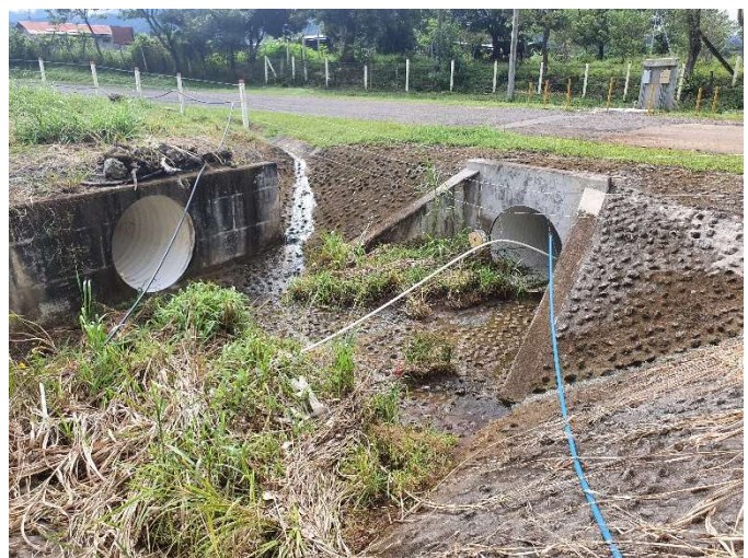
Fotografía 19: Punto de desfogue de varios flujos de escorrentía pluvial.
