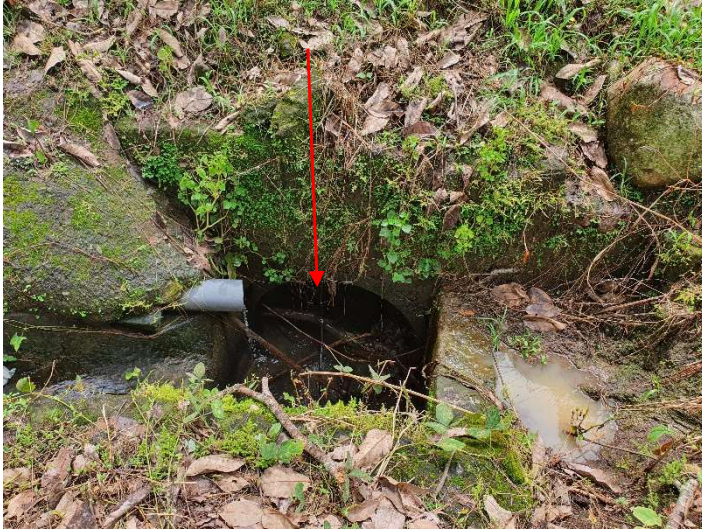
Fotografía 15: Punto desfogue pluvial alcantarillado de 1.10 m de diámetro
