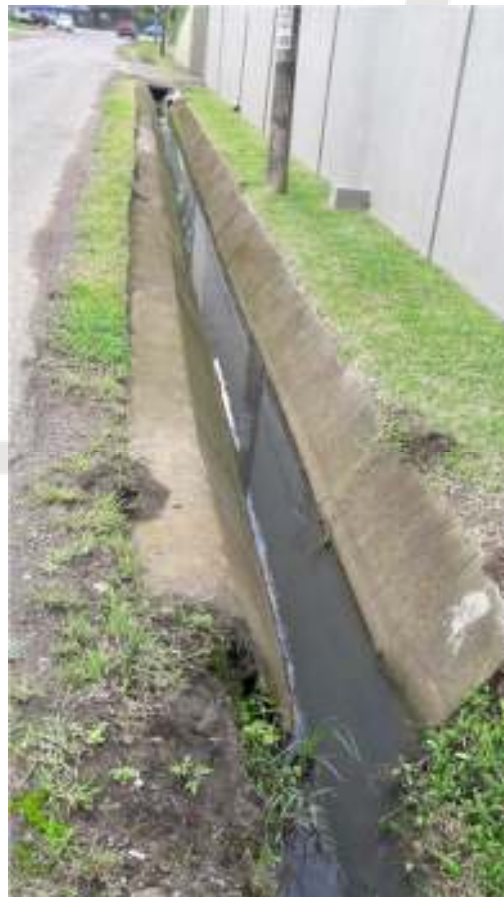
Problema evacuación aguas calle oeste
