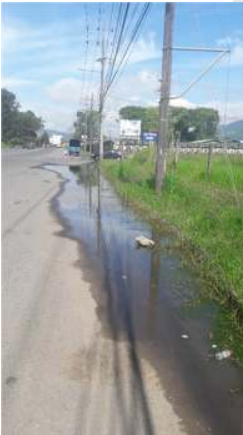
Problema evacuación aguas calle norte
