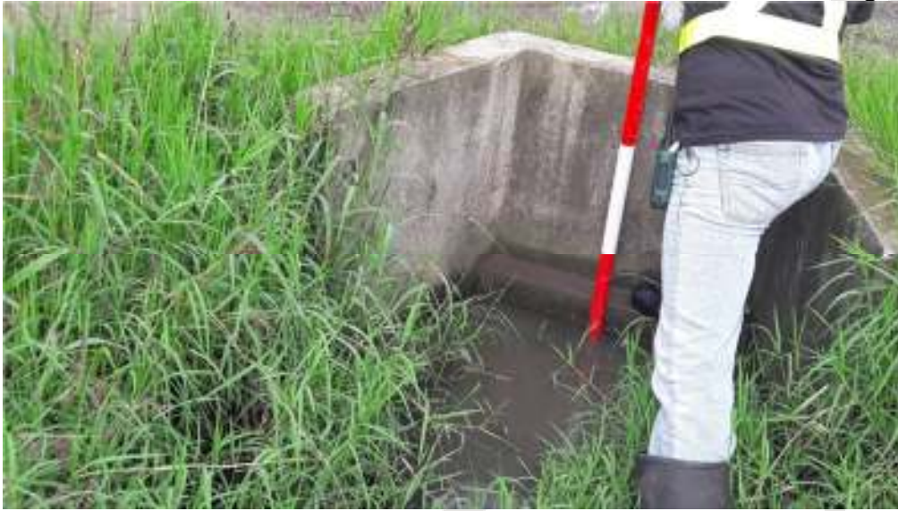
Problemas de evacuación de aguas en calle de acceso norte
