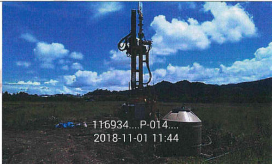
Proceso de la perforación P-14, equipo de rotación instalado en una zona con vegetación baja, de topografía bastante plana, y sin edificaciones.
