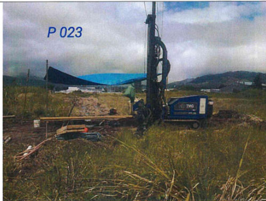
Proceso de la perforación P-23, equipo de rotación instalado en una zona con vegetación baja, de topografía bastante plana, y sin edificaciones.
