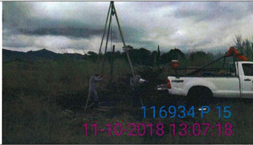
Proceso de la perforación P-15, realizada en una zona con vegetación baja, de topografía bastante plana, y sin edificaciones.
