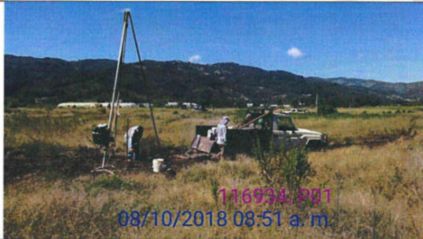
Proceso de la perforación P-1, realizada en una zona con vegetación baja, de topografía bastante plana, y sin edificaciones.
