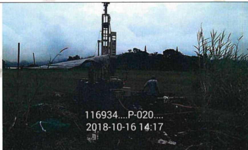
Proceso de la perforación P-20, equipo de rotación instalado en una zona con vegetación baja, de topografía bastante plana, y sin edificaciones.
