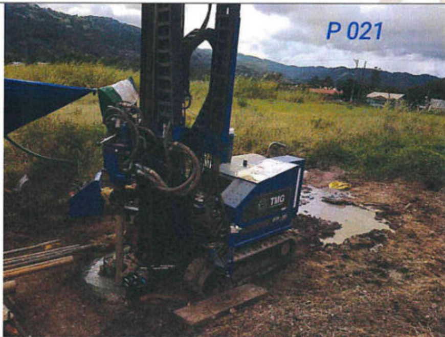
Proceso de la perforación P-21, equipo de rotación instalado en una zona con vegetación baja, de topografía bastante plana, y sin edificaciones.
