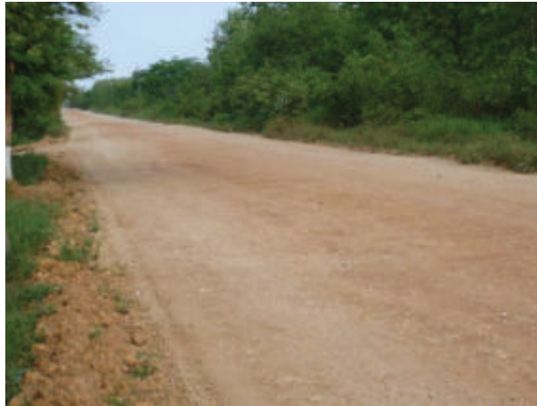
Ilustración 5: Estado actual de la carretera
