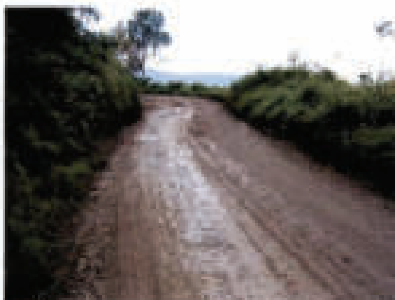
FOTO 4.1: Condiciones de Transitabilidad actual
