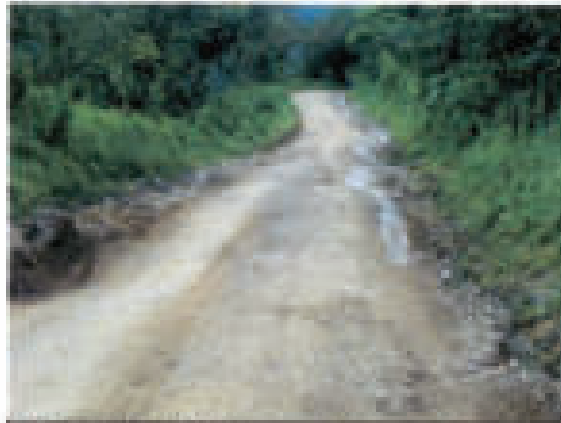
Foto N° 3.2 Detonata de la superficie por erosión superficial y paso vehicular
